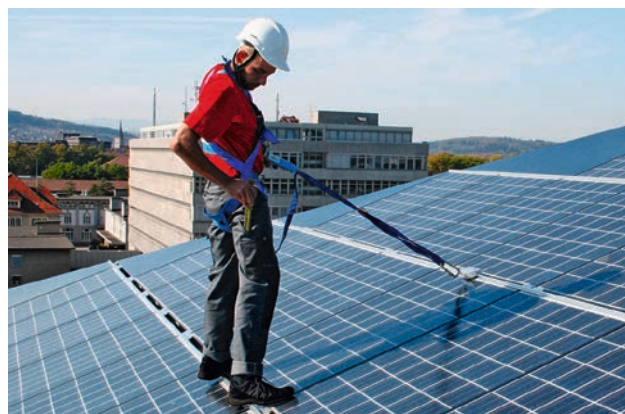
Bild 12 Anschlageinrichtung, in Solaranlage integriert
