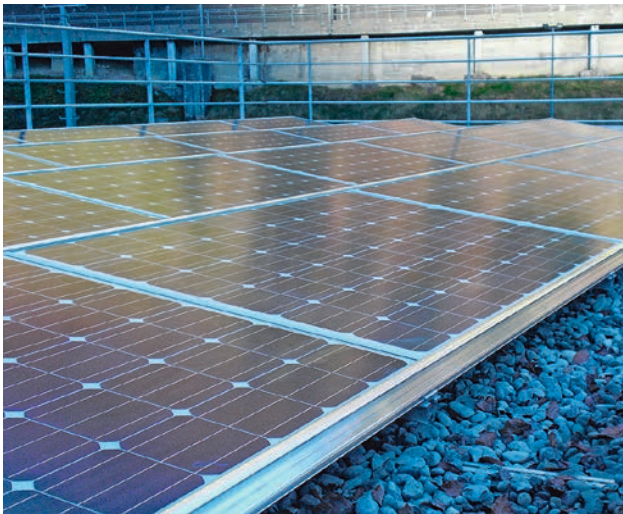
Bild 4 Solaranlage auf Flachdach mit umlaufendem permanentem Geländer
