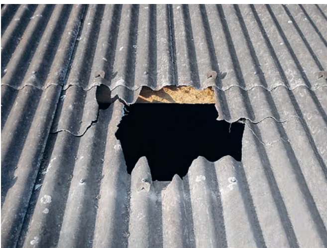
Abb. 8: Durchbruch bei Faserzementwellplatten
